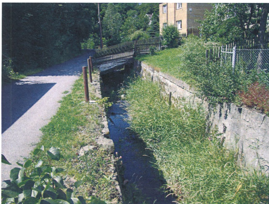
Foto č. 2 Poškozený mostek, ř. km 1,96 (po proudu)
