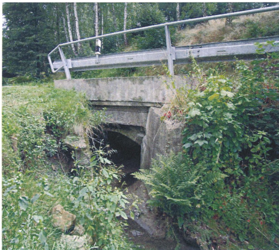
Foto č. 23 Silniční most ř. km 3,38 (proti proudu), zanesené koryto, sesutý pravý břeh
