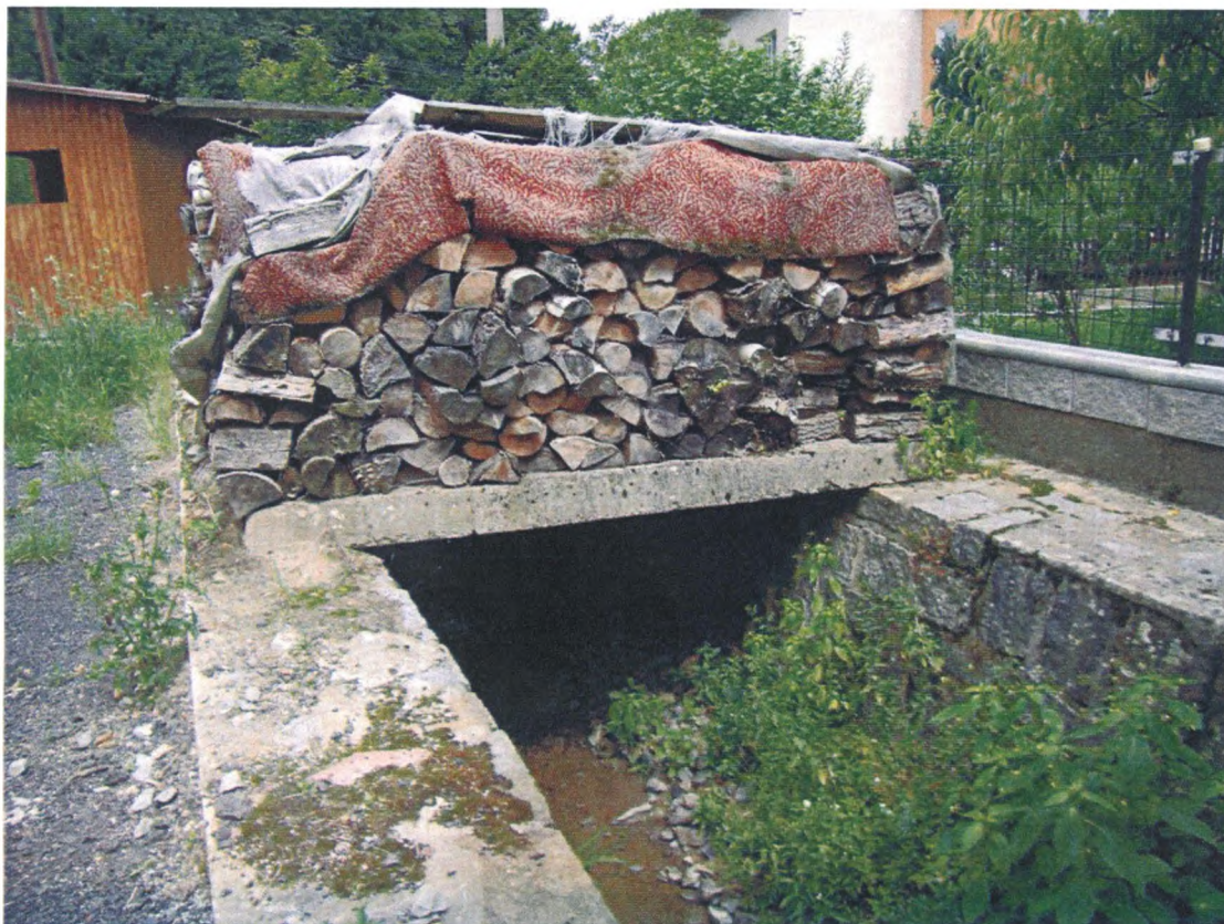
Foto č. 14 Zakrytí toku panelem a sklad dřeva pod výtokem ze zatrubnění, ř.km 3,04 (proti proudu)
